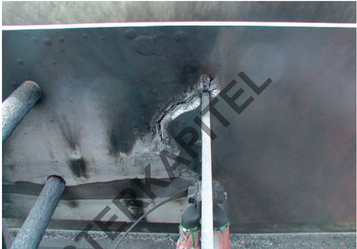
Bild 1.3 Teilentladungskanal in einer Isolierstoffplatte mit anschließendem Kurzschluss
